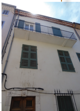
Ajout balcon sur façade et réseaux filants
