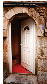
Porte PVC inadaptée
