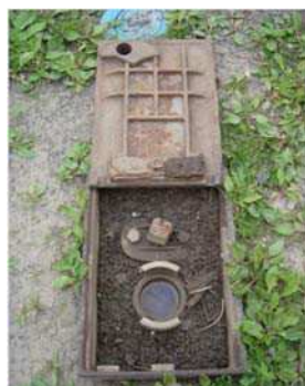
Bouche Incendie de 80 mm à tenons
